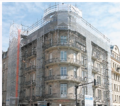
Protection couvreur sur un immeuble à Metz.
