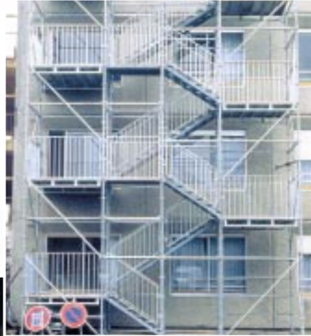
Escaliers de secours provisoires pour les établissements recevant du public (ERP)
