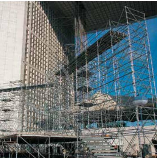
Parvis de La Défense : structure scénique pour la fête de la musique.
