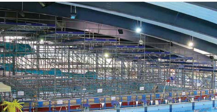
Montluçon : platelage pour le changement des suspentes du faux plafond de la piscine.
