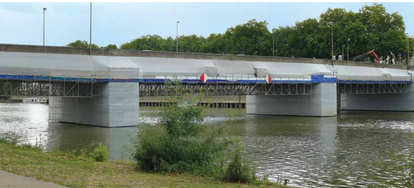
Angers : échafaudage suspendu pour la rénovation du pont de la Haute Chaîne.
