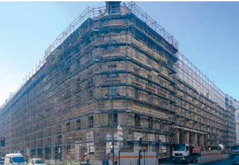
La poste du Louvre : 230 tonnes de Multicrab pour échafauder les 9200 m 2 des quatre faces du bâtiment.
