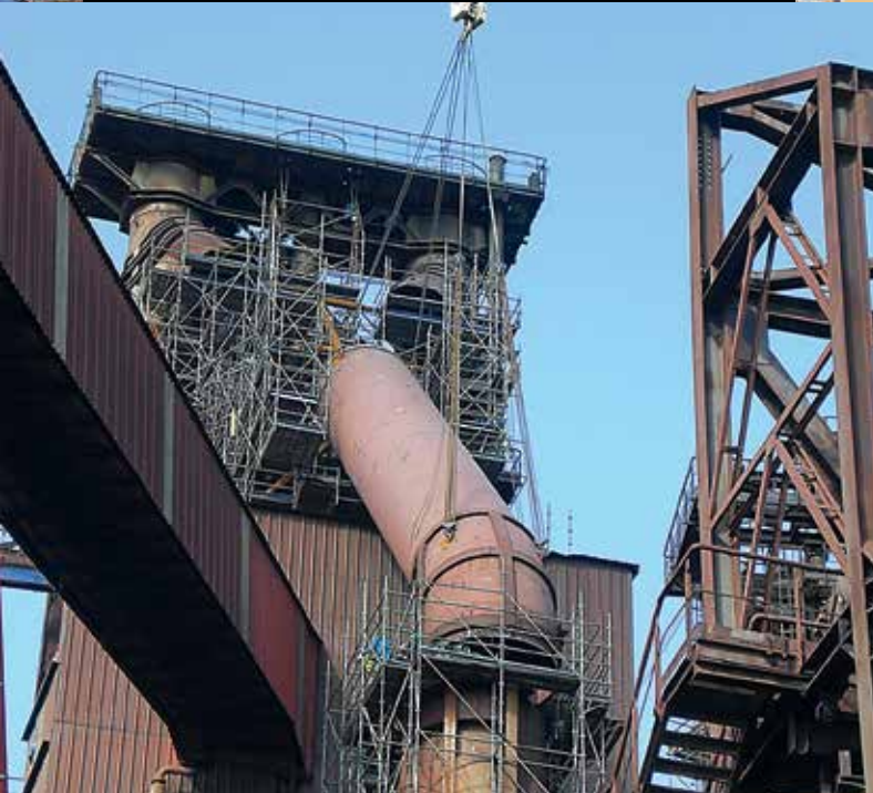
Site d'ArcelorMittal Atlantique et Lorraine : échafaudages pour travaux de maintenance sur le haut fourneau N°2.
