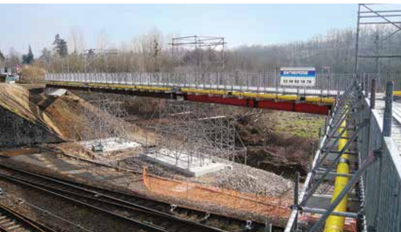
RN 21, entre Limoges et Périgueux : passerelle piétonnière provisoire durant la reconstruction du pont franchissant la voie SNCF.
